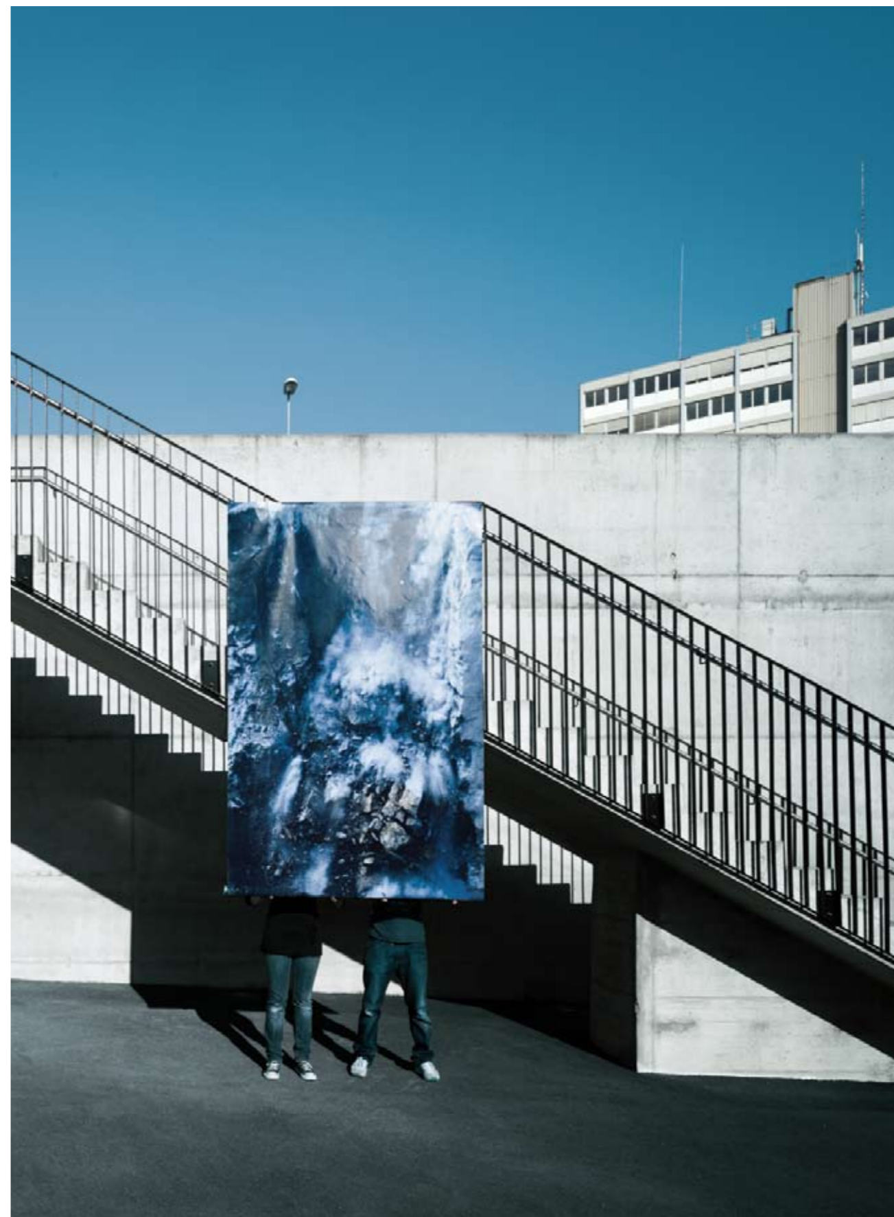
Steinschlag an der Fassade des Bürogebäudes W200 in Worblaufen. Kann man mit den richtigen Massnahmen vorbeugen? Chute de pierres sur la façade de l'immeuble de bureaux W200 à Worblaufen. Existe-t-il des mesures adéquates?
